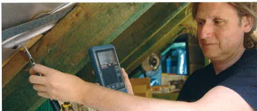
Holger Merkel untersucht das Haus nach ungewollten Luftströmen.
